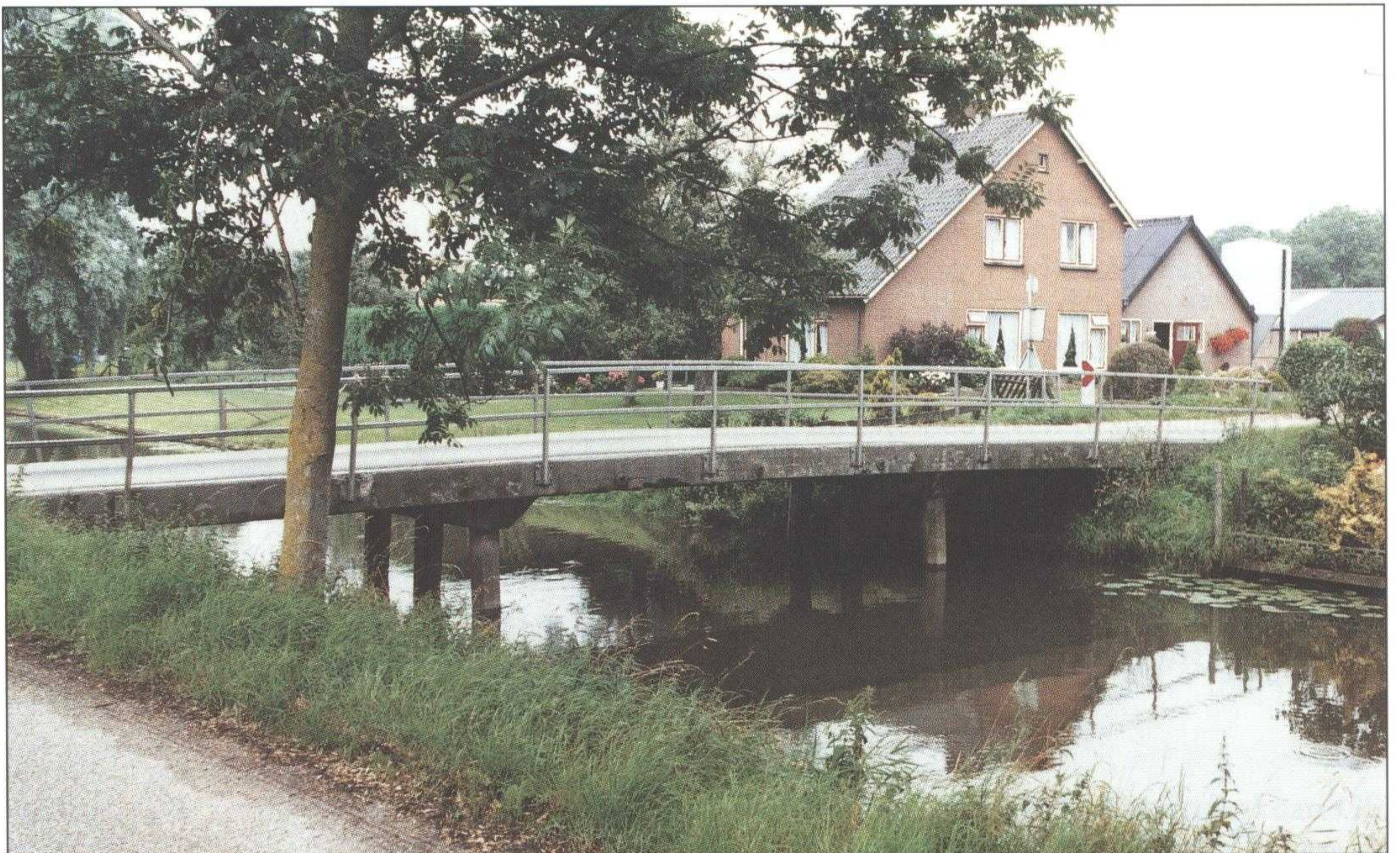
Brug over de Grift (in de tekst is dit de tweede brug), gelegen in het verlengde van de Dragonderweg. De brug is 7 meter breed en dit is eigenlijk te smal voor het tegenwoordige verkeer. De brug is in de eerste jaren na de Tweede Wereldoorlog gereedgekomen.
