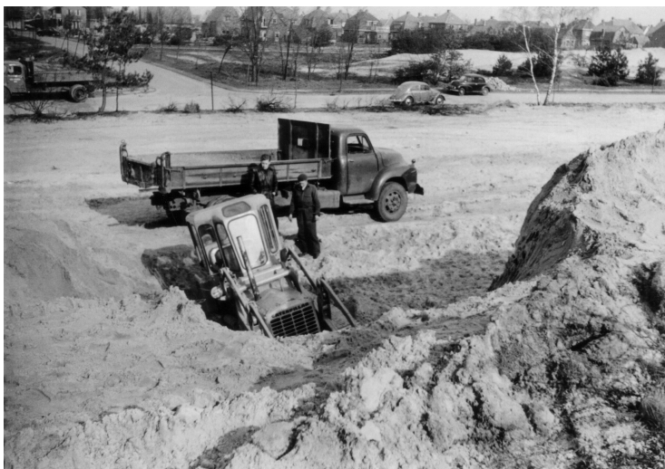
Egaliseren van het Beatrixpark. Op de achtergrond woningen aan de Verl. Maanderweg. Schuin in de hoek linksboven de Willem de Zwijgerlaan van Verl. Maanderweg naar Anna van Burenlaan. De shovel en de vrachtwagen halen zand weg achter de Beatrixkerk. (Collectie Van Lohuizen)
